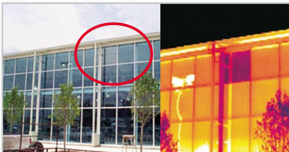
Bild 4: Baumangel schnell entdeckt: Die Thermografieinspektion deckt falsch eingebaute Fenster auf. Die Beschichtung ist innen statt außen am Fenster angebracht. (Bilder: FLIR)
