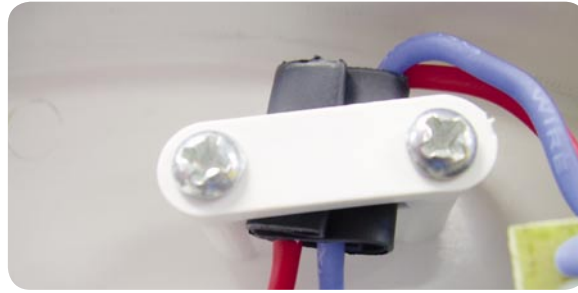
Bild 10: Üble Bastelei – Fixierung mit Schrumpfschlauch-Resten
