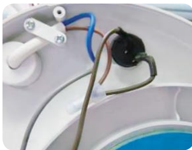
Bild 1: Noch akzeptable Verkabelung auf der Netzseite, allerdings ist diese Art Quetschverbinder eine potentielle Fehlerquelle.
