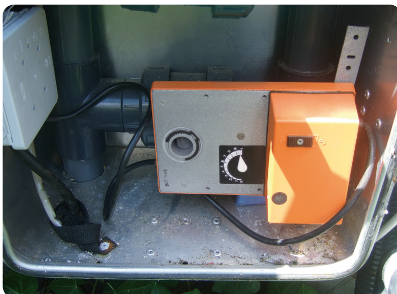
Bild 2: An den Belimo-Stellmotor SM220 wird einfach die Knebelwelle des Handventils (Bypassventil der Solarkollektoren) angeschraubt.
