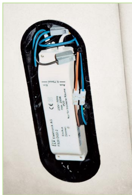
Bild 5: Einbau der Funkdimmer FS20 DI22 in einer Standard-Dreifach-Hohlwanddose auf dem Dachboden, um eine sichere und gut zugängliche Klemmstelle zu realisieren.
