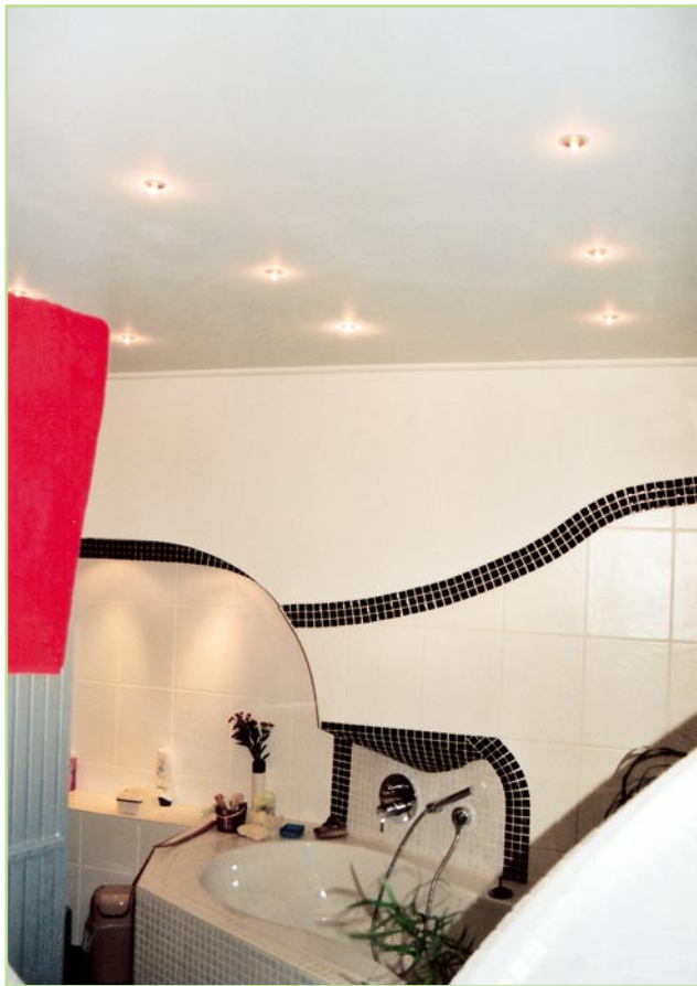
Bild 1: Die Aufgabe: Ein exklusives Bad war mit mehreren, dimmbaren Beleuchtungsgruppen in Niedervolt-Halogentechnik auszustatten.
