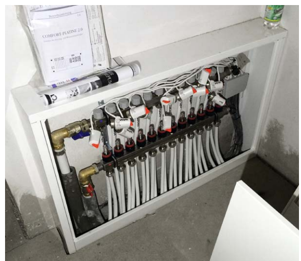
Bild 10: Für die Steuerung per HomeMatic vorbereitet – der Heizkreisverteiler der Fußbodenheizung
