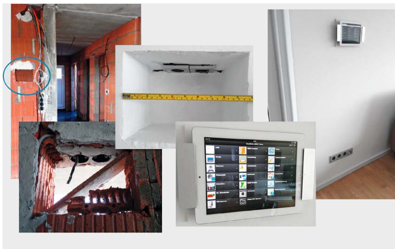
Bild 16: Von Anfang an eingeplant und so sauber eingebaut – Montageplatz für den als Bedienpanel arbeitenden Tablet-PC.
