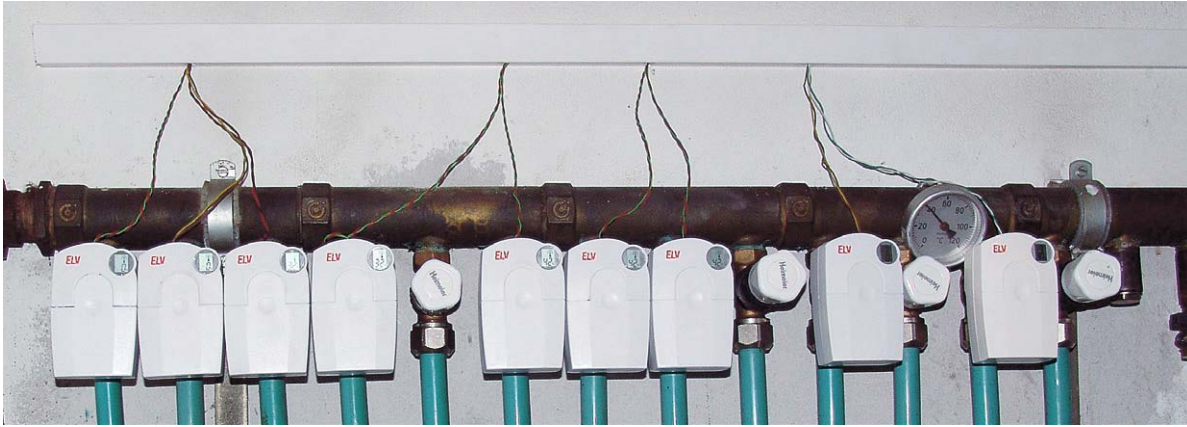
Bild 1: Der mit FHT-Ventilantrieben bestückte Heizkreisverteiler, Stand 2008
