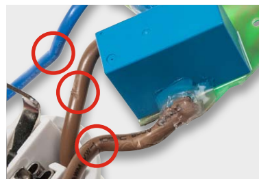
Bild 10: Können Folgeschäden nach sich ziehen: bei der Montage beschädigte Isolierungen
