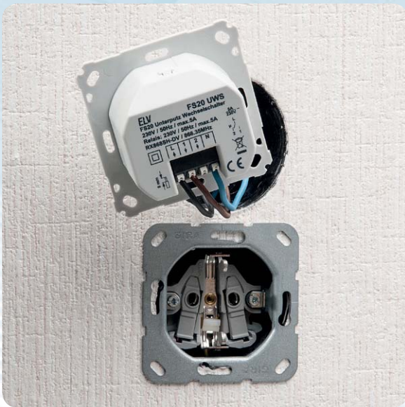
Bild 25: Der fertig verkabelte FS20 UWS ...
