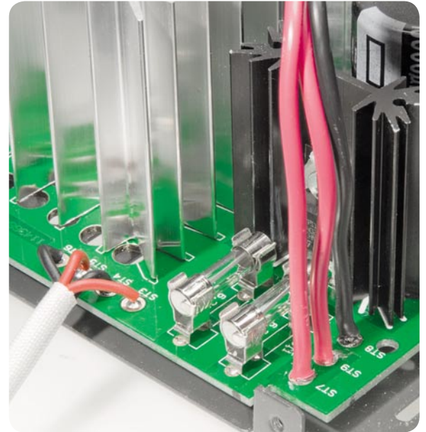
Bild 22: Anschluss der sekundärseitigen Trafoleitungen
