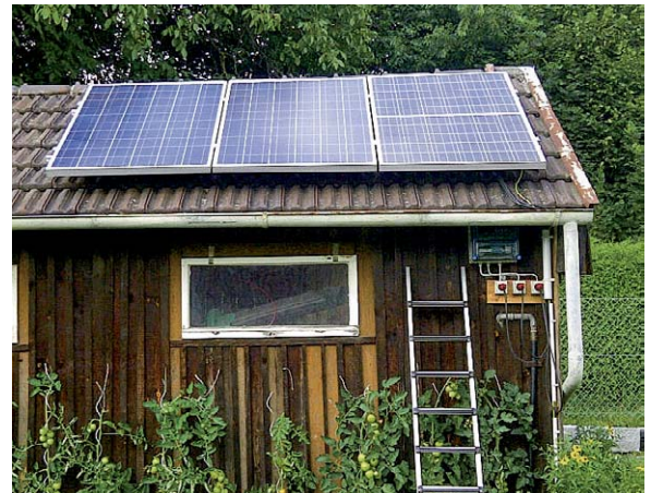
Eigenverbrauch mit Mini-PV-Anlagen: sauberer Storm für die Grundlast (Foto: SUNSET Energietechnik GmbH)
