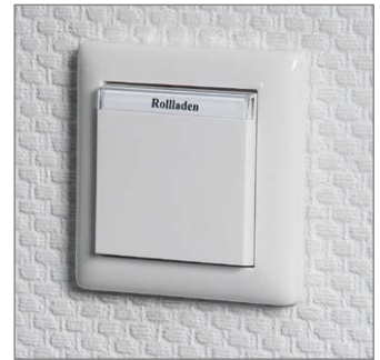
Bild 8: Nach erfolgter Montage kann der Stromkreis wieder eingeschaltet und der HomeMatic Funk-Rollladenaktor durch Eingabe der Seriennummer an der HomeMatic Zentrale CCU2 angelernt werden.
