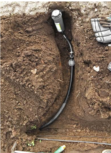
Bild 4: Installation einer Gardena-Wasserturbine T200 mit flexiblem 35-cm-Anschluss-Schlauch, was das Justieren der passenden Turbinenhöhe mit der Erdoberfläche deutlich vereinfacht.“
