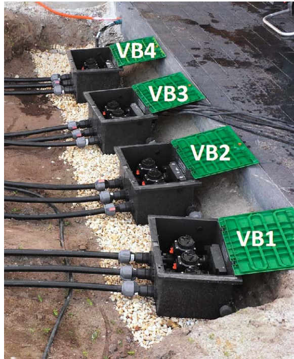
Bild 5: Die Ansteuerung der Turbinen übernehmen 12 Ventile, verteilt auf vier Gardena-V3-Ventilboxen.
