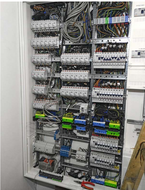
Bild 6: Der Grund für die Auswechslung für den Wired-Aktoren-Verteiler im Gartenhaus: vollbestückter Elektroschrank mit den HM-Wired-Aktoren im Hauswirtschaftsraum.
