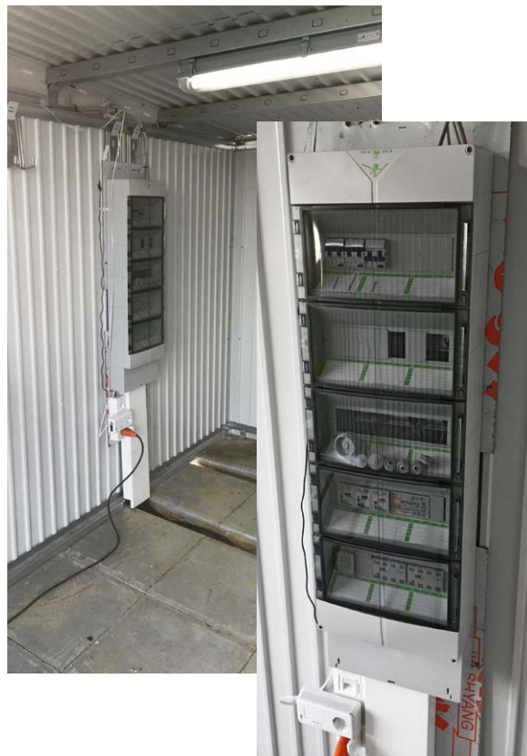
Bild 7: Zusätzlicher Elektroschrank-Verteiler für die HM-Wired-Aktoren, aufgestellt mangels Platz im HWR, nun im Gartenhaus.
