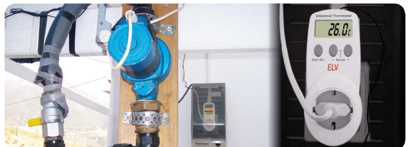
Bild 2: Der Universal-Thermostat UT 200 (hinten im Bild in einer wetterfesten Box) steuert die Wasserpumpe: Sobald am Solarkollektor eine Temperatur ab 28 °C gemessen wird, wird der Wasserkreislauf gestartet. Sinkt die Temperatur auf unter 26 °C, geht die Pumpe aus.
