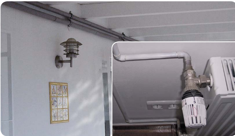
Bild 5: Ein nachgerüsteter Heizkörper kann mit dem erhitzten Wasser aus den Solarpanels beliefert werden.
