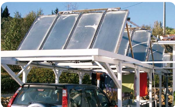
Bild 1: 12 Solarpanels heizen auf dem Carportdach Wasser auf.
