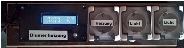
Bild 1: Die komplette Steuerung, gemeinsam mit den zugehörigen Netzsteckdosen auf einem Brett montiert
