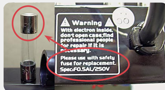
Bild 8: Sicherung mit viel zu hoher Auslösestromstärke statt der nominellen Sicherung verbaut
