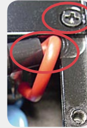
Bild 5: Unsichere Erdungsverbindung und Gefahr für die Isolierung der Netzleitung an der scharfen Kante
