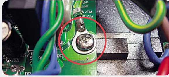
Bild 3: Schutzleiter falsch angeschlossen – keine sichere Erdung!
