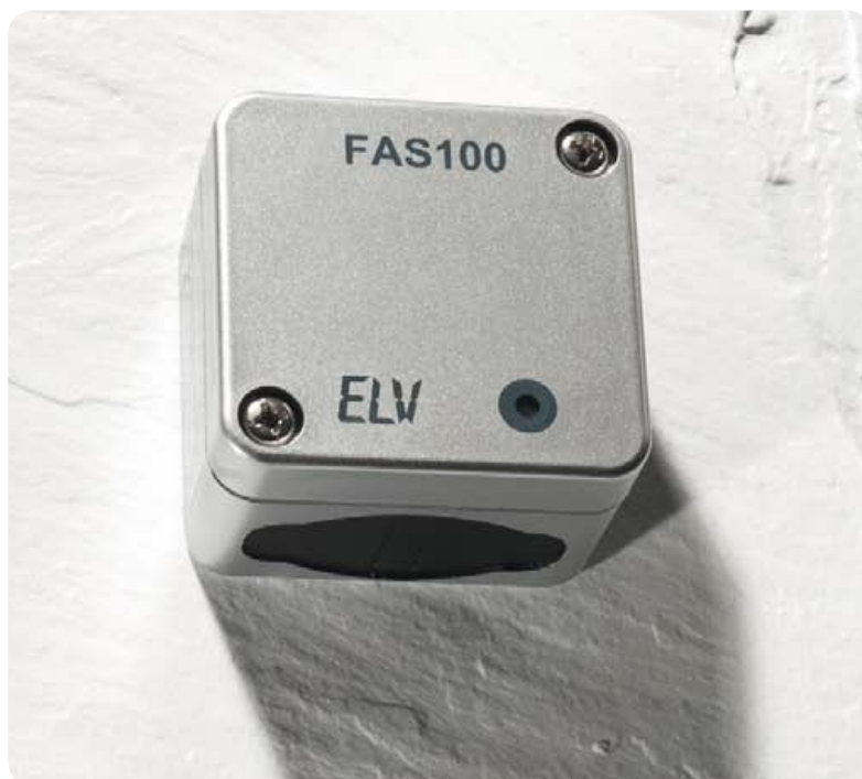
Bild 12: Der an einer Außenwand montierte Sensor
