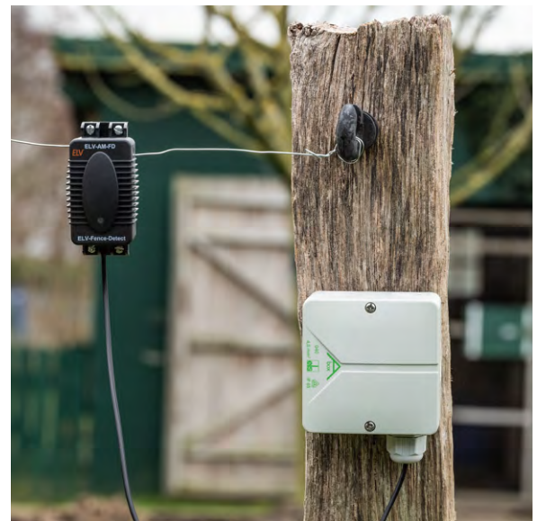
Bild 4: Fertig montierte Weidezaunüberwachung
