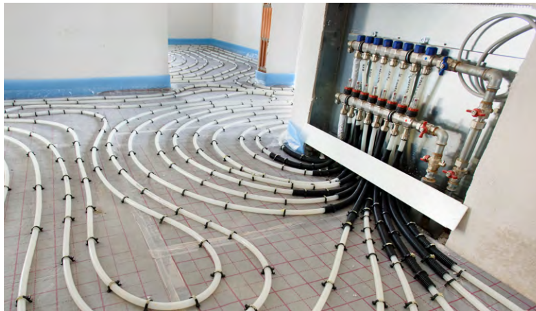
Bild 8: Fußbodenheizung mit Heizkreisverteiler
