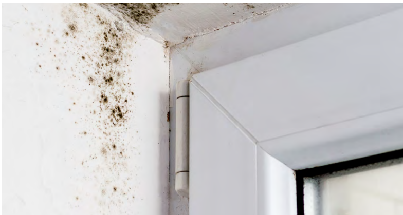
Bild 1: Schimmelausbreitung wird insbesondere durch Feuchtigkeit begünstigt.
