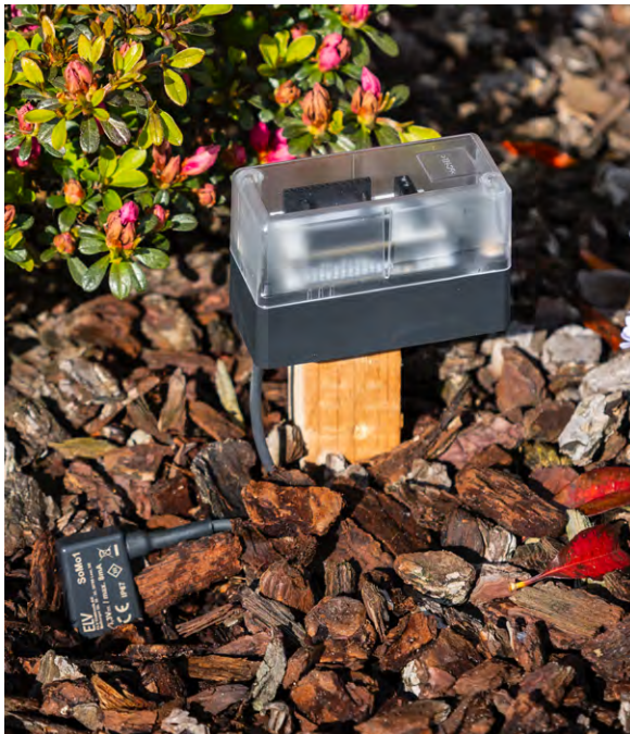
Bild 14: Im Garten verbaute fertige Sensoreinheit
