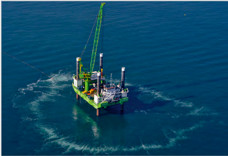
Bild 10: Unterwasserschallschutz mithilfe eines Luftblasenschleiers oder -vorhangs, der den Offshore-Pfahl während der Rammarbeiten umgibt und so die Unterwasserwelt mit ihren Lebewesen vor schädlichem Lärm schützen soll
