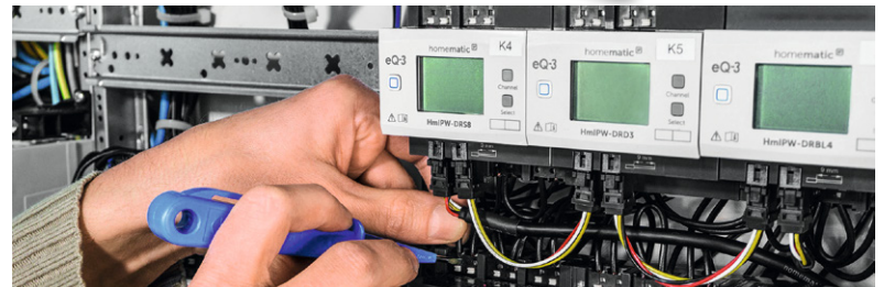
Bild 1: Viele Smart-Home-Geräte bedingen einen fachgerechten Anschluss an das 230-V-Netz.
