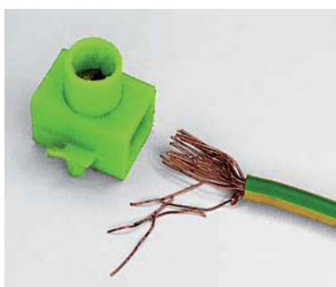
Bild 3: Typische Beschädigung, die beim Fixieren von feindrätigen Leitern in einer Schraubverbindung auftreten kann.
