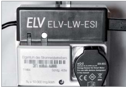
Anwendungsbeispiel mit Stromzähler
