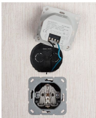
Bild 15: Der fertig verkabelte Wandsender ...
