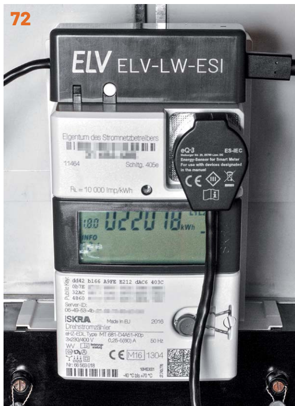
Energieverbrauch im Visier
