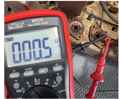
Bild 10: Messung des Widerstands der Heizwicklung ohne Röhren oder Lampen im Stromkreis
