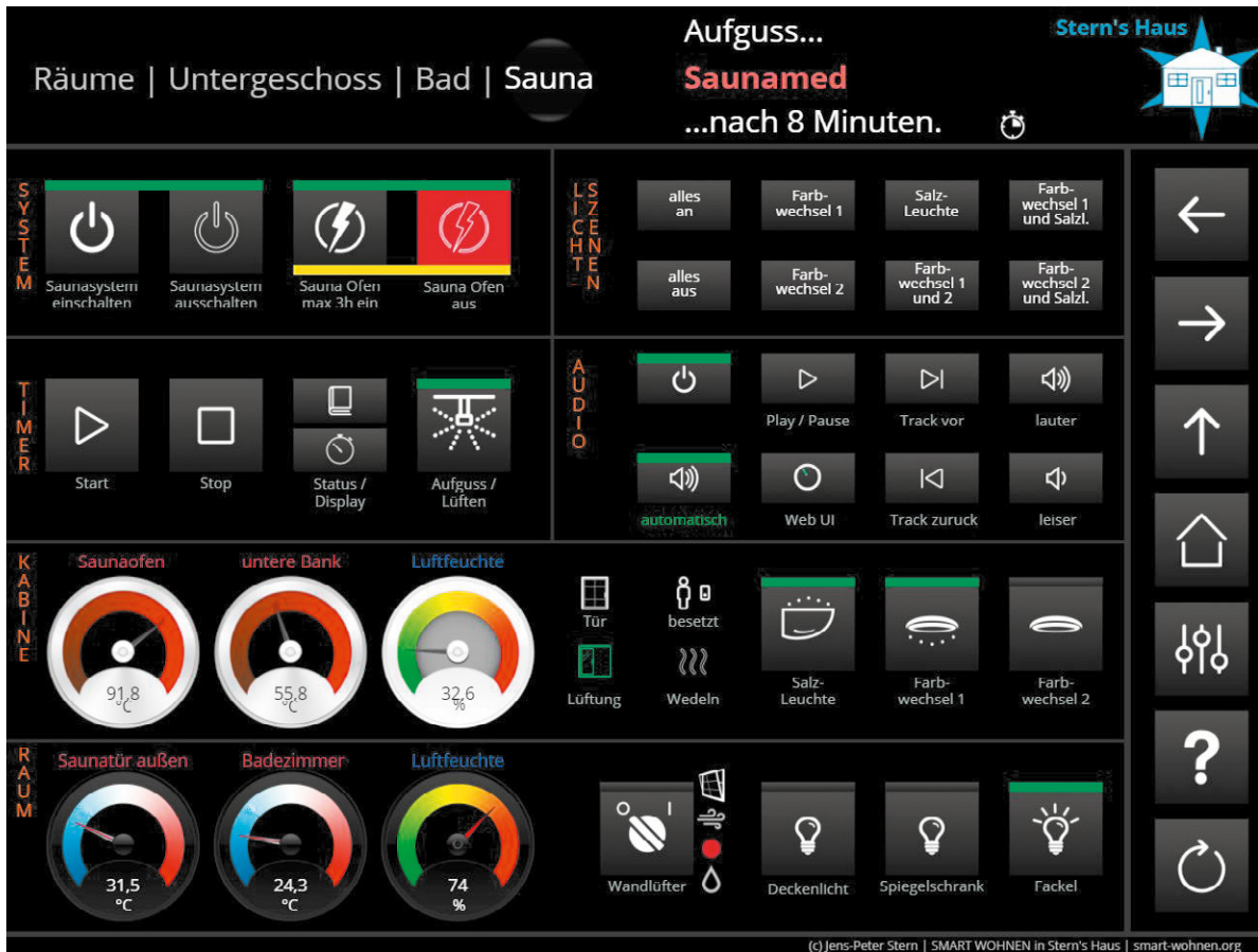
Bild 9: Gesamtansicht der Saunasteuerung in der mediola App
