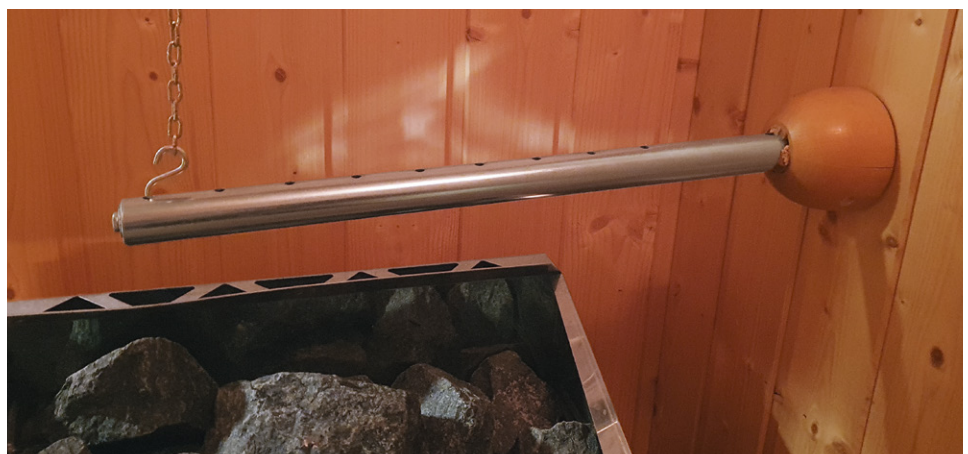
Bild 6: Ofenbrause mit Fixierung durch eine Kette am Ende des Stahlrohrs
