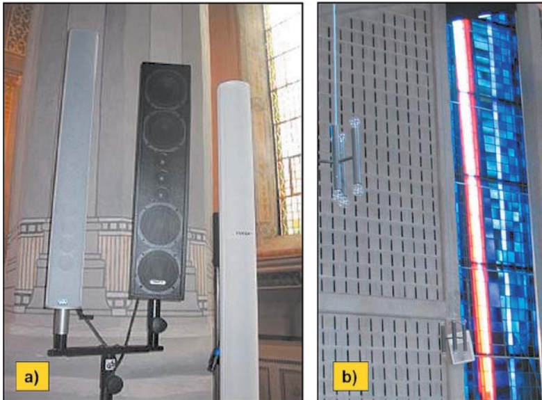
Bild 7: Akustik in Kirchen a) Lautsprecherzeilen zur gerichteten Beschallung in Kirchen b) Kirchenwände belegt mit Resonanzabsorbentern zur Verringerung des Nachhalls
