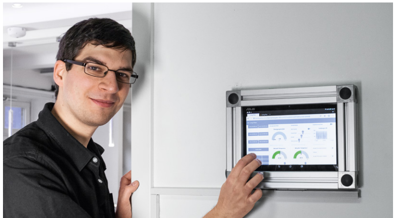
Student Fabian Erdmann hat am Eingang des Labors ein Tablet mit Software installiert, über das man die im „Living Place“ verbauten Homematic Geräte steuern bzw. deren Daten abrufen kann.
