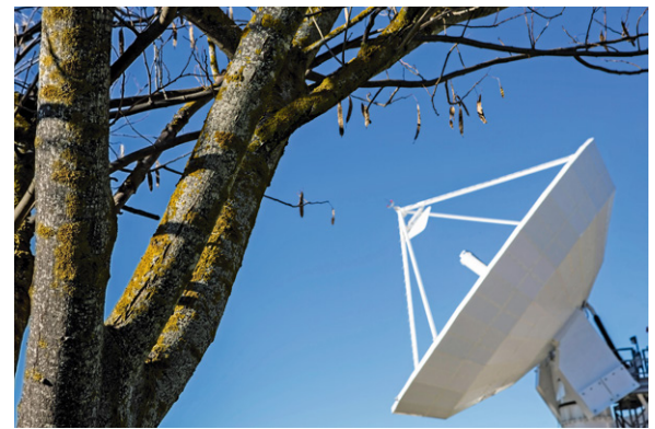
Bild 7: Über diese 13-m-Antenne in der EAN-Satelliten-Bodenstation in Nemea, Griechenland, wird der satellitenbasierte Datenverkehr zwischen S-Band EAN/Hellas Sat 3 und Flugzeug abgewickelt.
