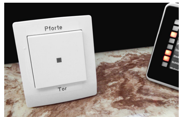
Bild 4: Der Schaltaktor für Kleinspannung für die Schiebetorsteuerung kann aus dem Haus bequem per Funktaster gesteuert werden, ...
