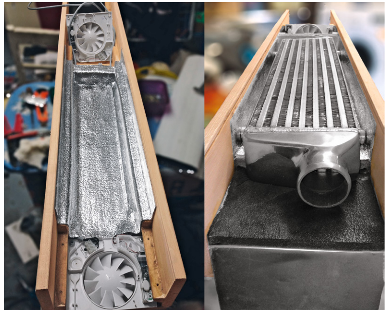
Bild 4: Die Schall- und Wärmeisolierung des Wärmetauschers
