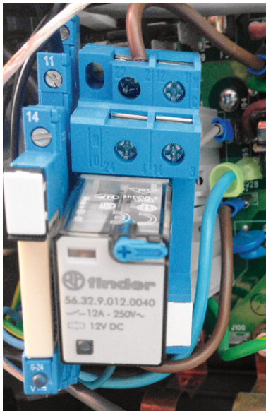
Bild 3: Steckbrücke und nachgerüstetes Finder-Relais für die Heizung
