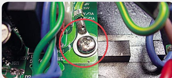
Bild 3: Schutzleiter falsch angeschlossen – keine sichere Erdung!
