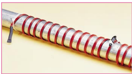
Bild 12: Beispiel: Heizleitung mit Temperatursensor der NSH 50, an einer Wasserleitung montiert
