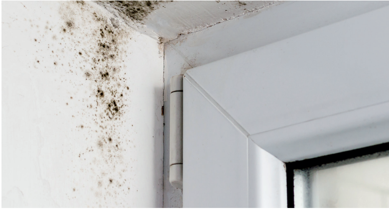
Bild 1: Schimmelausbreitung wird insbesondere durch Feuchtigkeit begünstigt.
