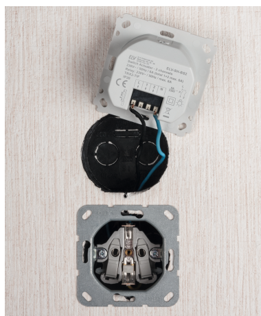
Bild 15: Der fertig verkabelte Wandsender ...
