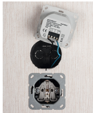
Bild 15: Der fertig verkabelte Wandsender ...
