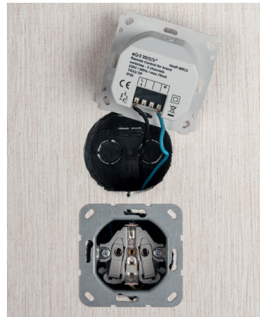
Bild 15: Der fertig verkabelte Wandsender ...
